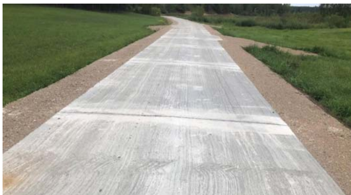
Fot. 5. Powierzchnia nawierzchni odcinka OT-2 (fot. M. Wasilewska)
