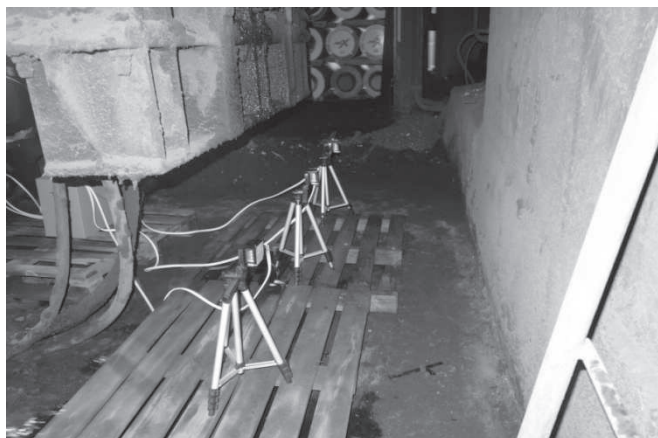
Rys. 4. Ustawienie czujników laserowych DT-50 pod siłownikami elektrod pieca łukowego
