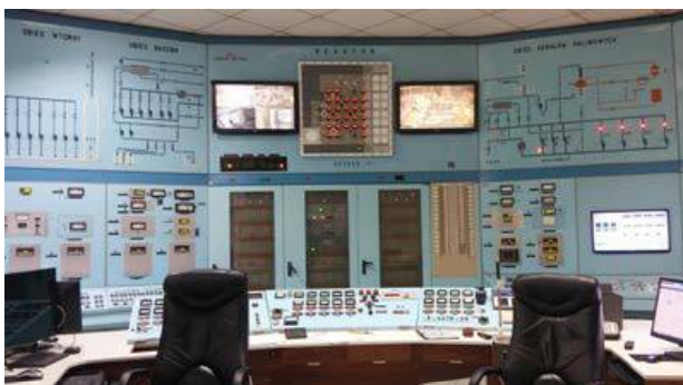
Fot. 6. Widok ogólny sterowni reaktora MARIA w 2018 r. (fot. A. Mikulski)
