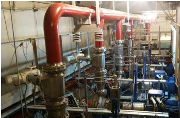
Fot. 3. Widok czterech nowych pomp głównych pierwotnego obiegu chłodzenia kanałów paliwowych (fot. Andrzej Mikulski)
