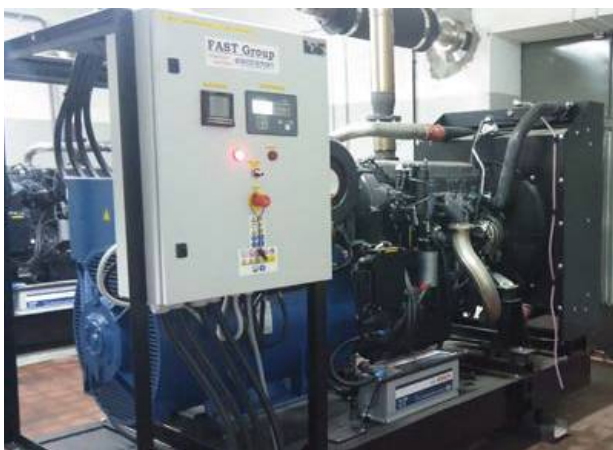
Fot. 5. Widok jednego z dwóch nowych awaryjnych agregatów Diesla (fot. A. Mikulski)
