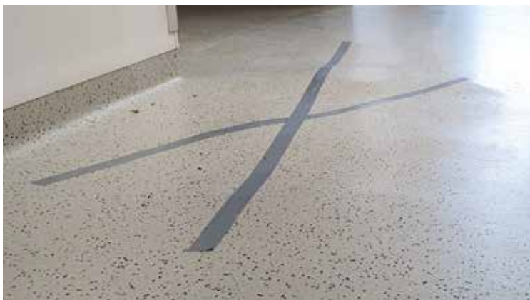
Lokalne zapadnięcie posadzki
