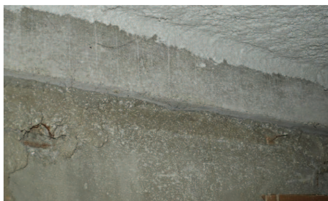
Rys. 9b. Podczas modernizacji termicznej budynków systemu OWT-67 (wspomagającej metodę lekką-mokrą zastosowaną na zewnątrz budynku) zastosowano wewnątrz (w płaszczyźnie stropu nad nieogrzewaną piwnicą) metodą natryskową izolacji termicznej. Brak izolacji w płaszczyźnie pionowej domykającej mostek liniowy (foto archiwum autora)
