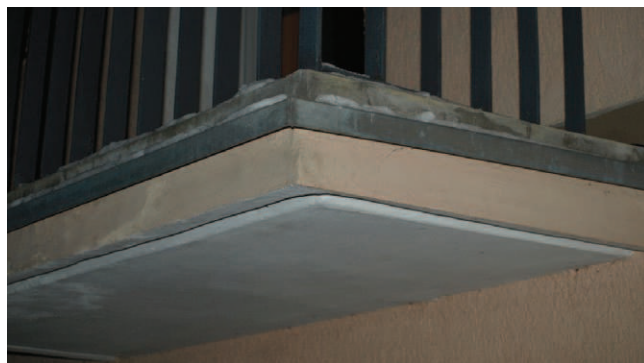
Rys. 9a. Podczas modernizacji termicznej budynków systemu OWT-67 metodą lekką-mokrą nie dokonano likwidacji strat ciepła poprzez mostek liniowy, tworzący żyłkę termiczną (foto archiwum autora)
