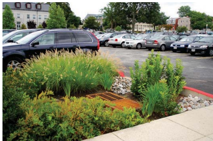
Fot. 4. Wyspa środkowa na terenie parkingu – widoczny przelew awaryjny, Blair County, Pennsylvania USA [ 40]
