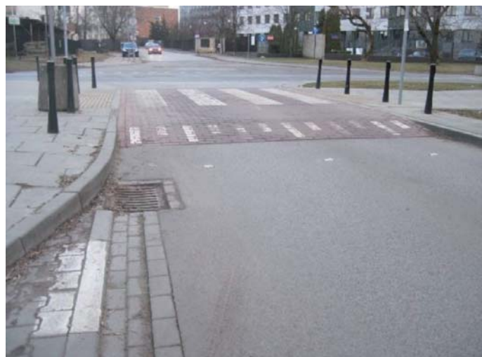
Fot. 1. Liniowy próg zwalniający płytowy z wpustem kanalizacyjnym od strony napływu wody
