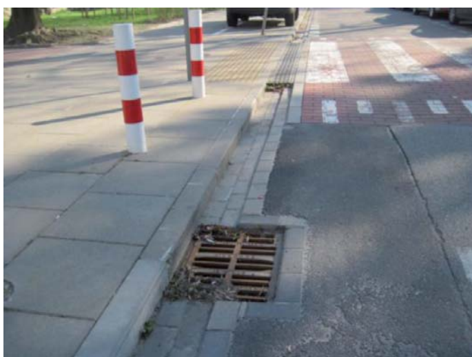
Fot. 7. Brak zamulenia przed progiem jako efekt wykonania wpustu od strony napływu wody – wiosna
