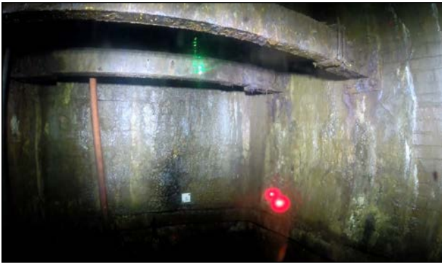
Fot. 3. Stan wschodniej i południowej części obudowy szybowej na głębokości około 7,0 m pod poziomem posadzki piwnicy szybowej - stan sprzed rozpoczęcia I etapu robót iniekcyjnych
