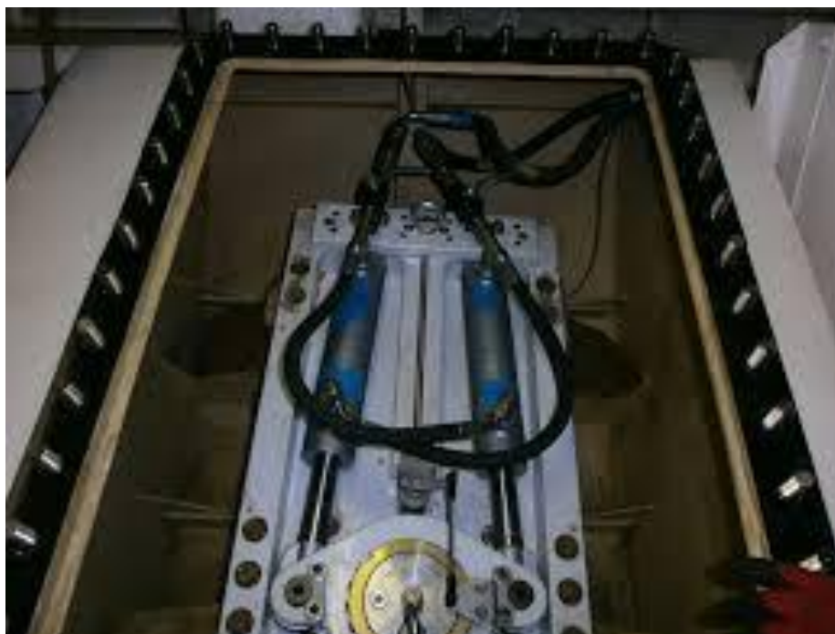
Rys. 2.. Widoki na zespół napędu hydraulicznego steru strumieniowego na pokładzie jachtu morskiego Źródło: Navimo Inc. catalogue [6]
