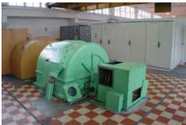
Fot. 19. Napęd sprężarki sprężarki TK-16 w KWK „Borynia” [4]
