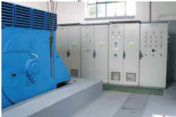
Fot. 21. Napęd wentylatora z przemiennikiem częstotliwości w KWK „Staszic” [4]
