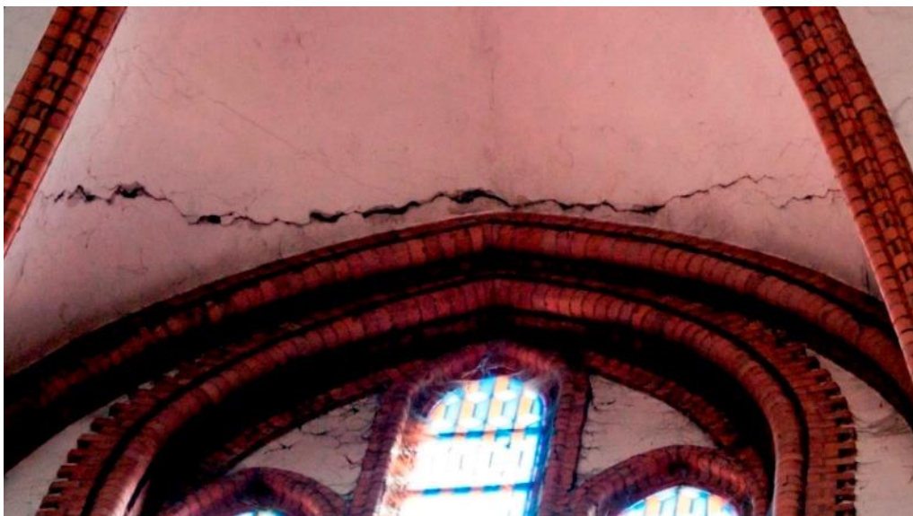
Rys. 3. Uszkodzenia sklepień budynku kościoła
