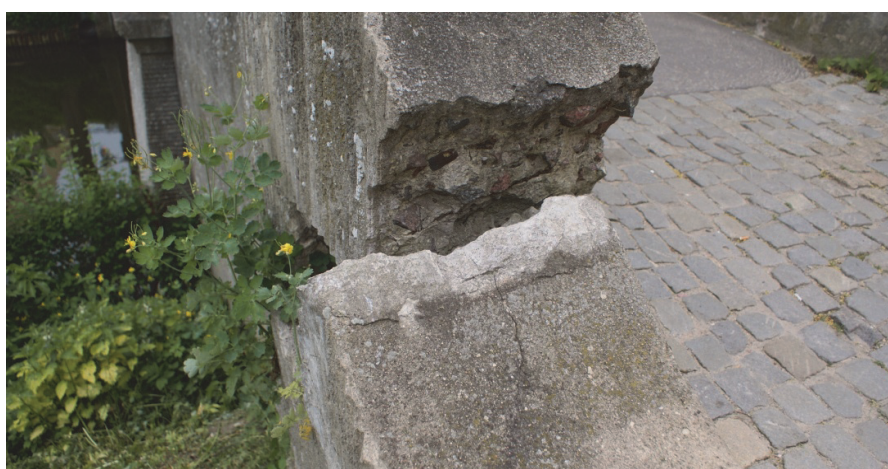
Rys. 8. Pęknięcie balustrady w skrajnej części przęsła – brak widocznego zbrojenia
