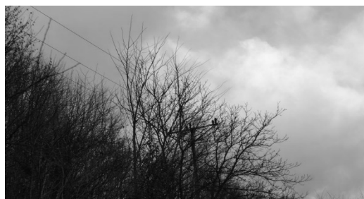
Rys. 7. Zaniedbana linia SN na terenie leśnym
