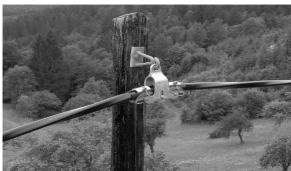
Rys. 9. Linia napowietrzna z przewodami izolowanymi na słupie drewnianym [9]
