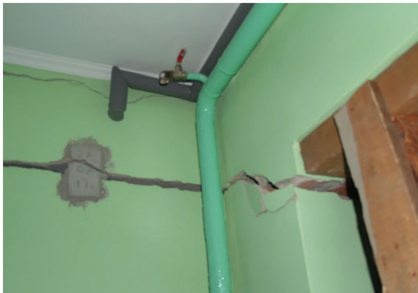
Fot. 4. Przedszkole, uszkodzenie ściany zewnętrznej, widok od środka, 2011 r.
