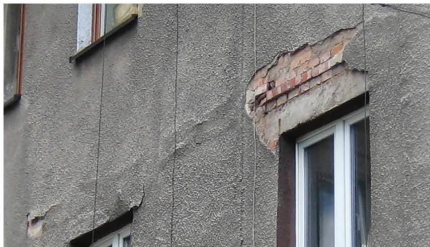
Fot. 2. Budynek mieszkalny, uszkodzenie elewacji, 2016 r.
