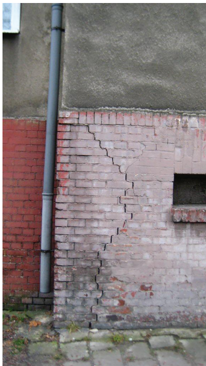
Fot. 3. Uszkodzona ściana przyziemia, budynek mieszkalny, 2013 r.
