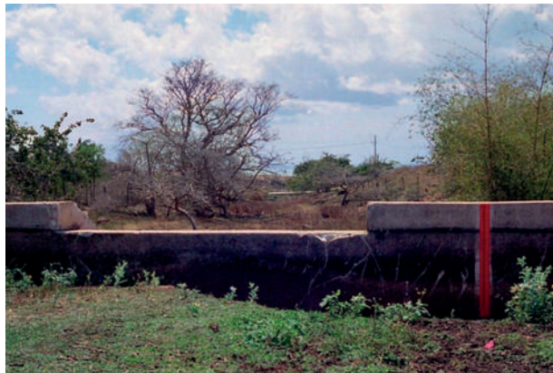
Rys. 9. Wodowskaz na zaporze zbiornika retencyjnego Bassin Boeuf (zdjęcia z prywatnego archiwum autora)
