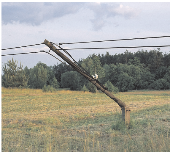
Rys. 2. Złamany drewniany słup w sieci dostępowej
