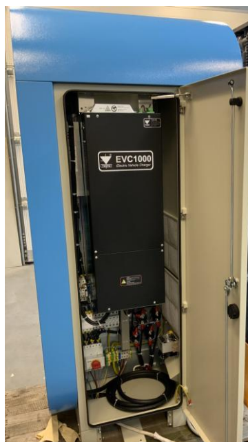
Rys. 1. Moduł ładowania EVC1000 zainstalowany w stacji ładowania EV
