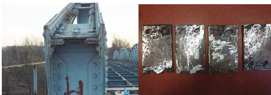
Rys. 4. Miejsce pobrania próbki i zdemontowane przewiązki pasa górnego
