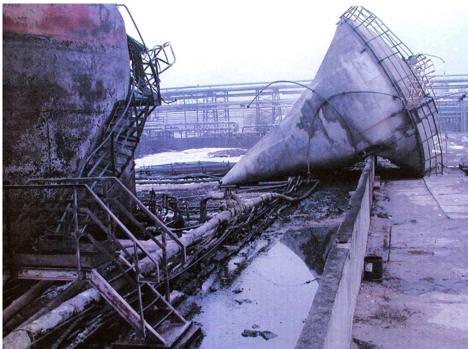
Fot. 5. Deformacja zbiornika ZM2, widoczne oderwanie od fundamentów i przemieszczenie na zewnątrz ściany betonowej.
