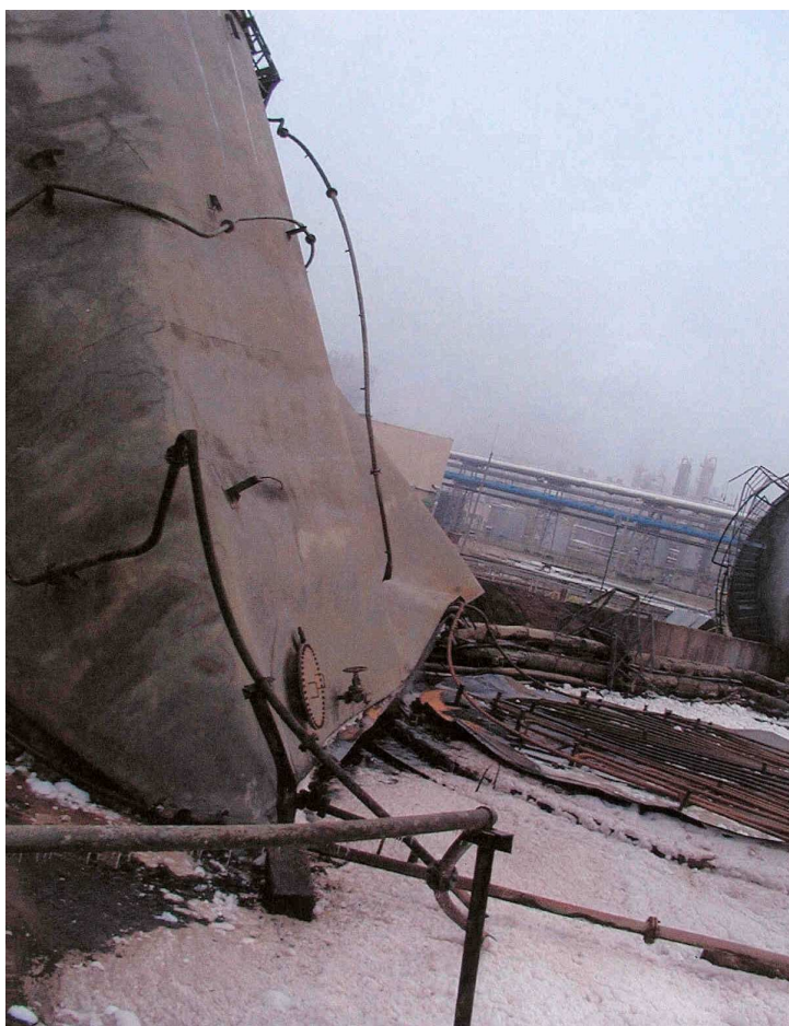
Fot. 6. Deformacja zbiornika ZM3 po wybuchu z wyraźnym przemieszczeniem od fundamentów.
