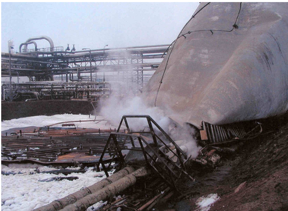
Fot. 7. Deformacja zbiornika ZM3.
