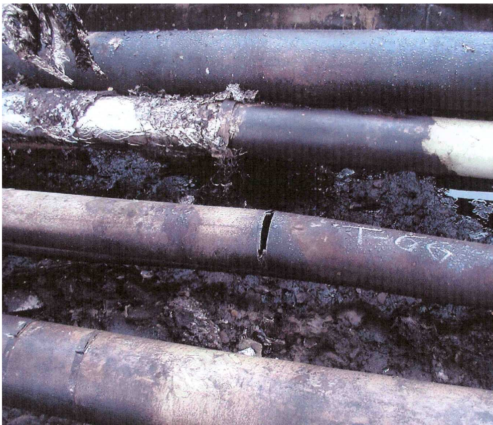
Fot. 1. Pęknięcie rurociągu T-66.
