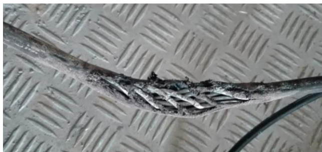
Rys. 3. Mechaniczne uszkodzenia kabla skręcanego z wielu cienkich żył aluminiowych [fot. Opracowanie własne autorów artykułu]
