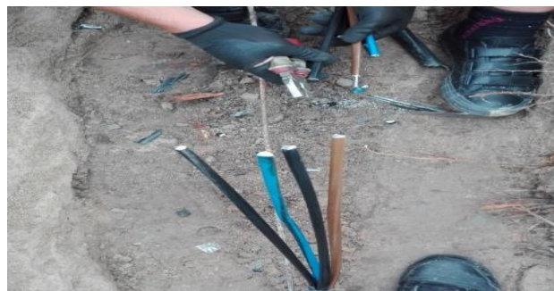
Rys. 12. Oczyszczanie kabla z izolacji zewnętrznej i usunięcia uszkodzonych żył [fot. Opracowanie własne autorów artykułu]
