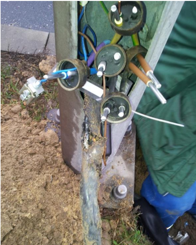
Rys. 7. Uszkodzenie zewnętrznej powłoki kabla zasilającego oświetlenie uliczne (Opracowanie własne autorów artykułu)
