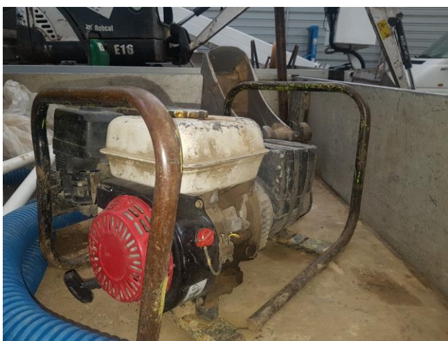
Rys. 30. Agregat prądowtórca wytwarzający napięcie rzędu 230V do zasilania urządzeń elektrycznych [fot. Opracowanie własne autorów artykułu]
