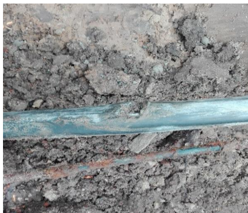
Rys. 4. Proces starzenia się izolacji [fot. Opracowanie własne autorów artykułu]
