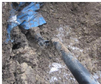
Rys. 5. Mechaniczne uszkodzenie kabla 1 [fot. Opracowanie własne autorów artykułu]
