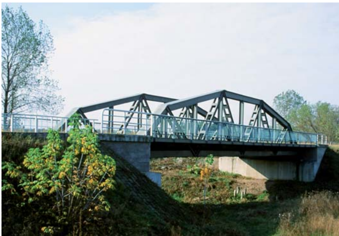
Fot. 10. Pierwszy w świecie stalowy spawany most drogowy przez rzekę Stodnię pod Łowiczem, fot. Marek Mistewicz, 1990 r. (ze zbioru autora)
