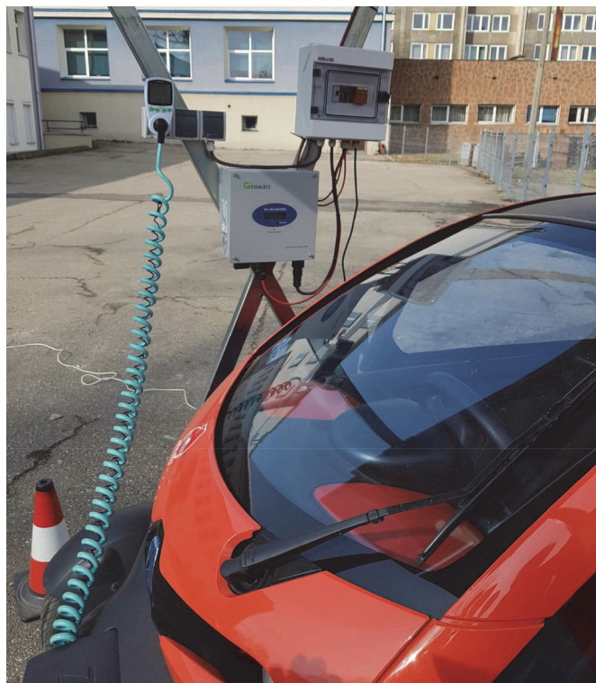
Fot. 4. Podłączenie pojazdu elektrycznego do carportu celem ładowania baterii
