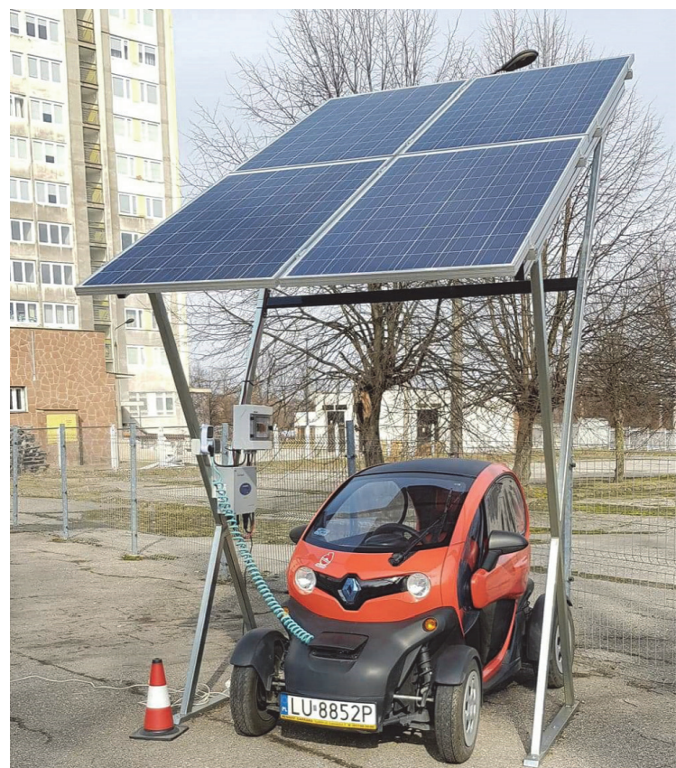
Fot. 2. Pojazd elektryczny podczas ładowania baterii z minicarportu fotowoltaicznego
