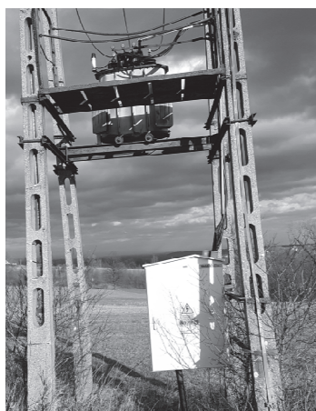
Rys. 1. Transformator napowietrzny o mocy pozornej 250kVA (Transformator 1)
