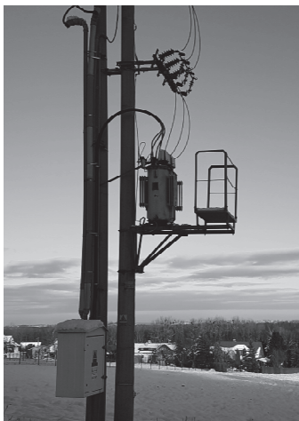
Rys. 2. Transformator napowietrzny o mocy pozornej 150kVA (Transformator 2)
