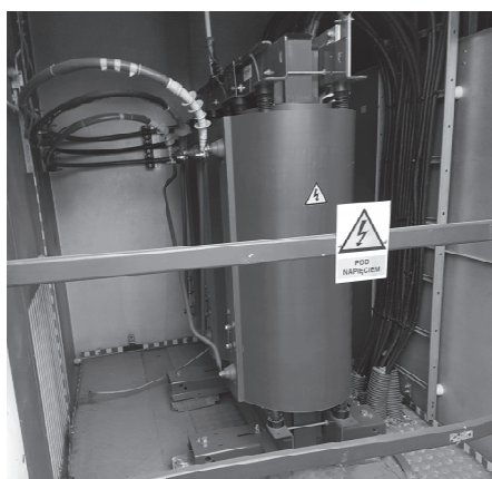
Rys. 3. Transformator wewnętrzny o mocy pozornej 1250kVA (Transformator 3)
