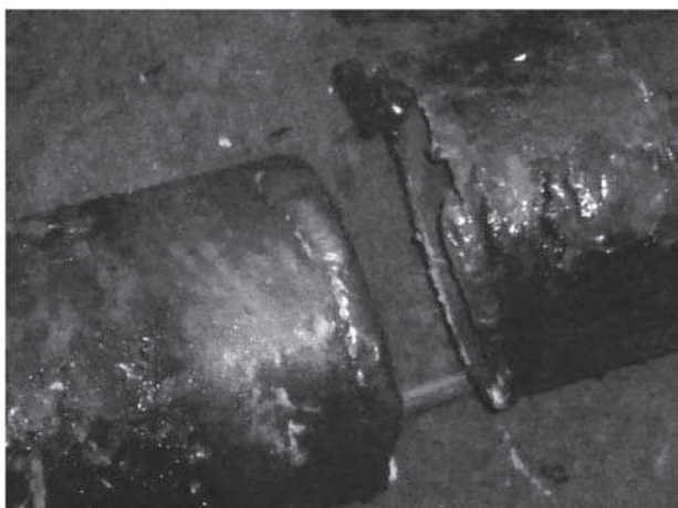
Rys. 10. Pęknięcie rurociągu stalowego w strefie rozciągania warstwy gruntu [4]
