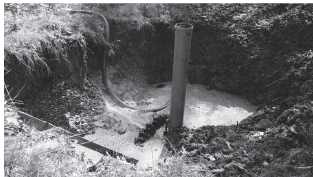
Rys. 8. Utrata szczelności pierścienia gumowego w złączu nasuwki kompensacyjnej wskutek poluzowania śrub mocujących. Źródło: Opracowanie własne
