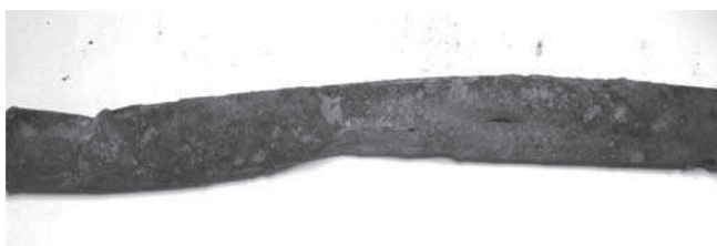
Rys. 9. Deformacja i korozja wodociągu stalowego w strefie ściskania warstwy gruntu. Źródło: Opracowanie własne
