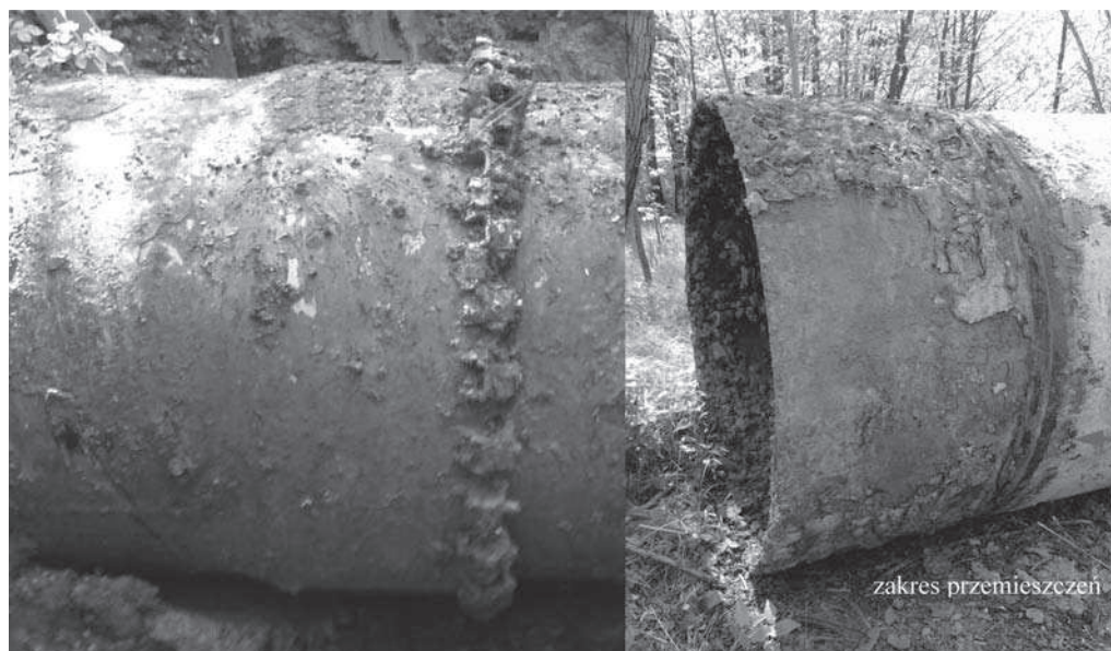
Rys. 5. Jednostronna nasuwka kompensacyjna zamontowana na sieci wodociągowej (z lewej) i koniec rury zdemontowanej nasuwki po kilkudziesięciu latach pracy. Źródło: Opracowanie własne
