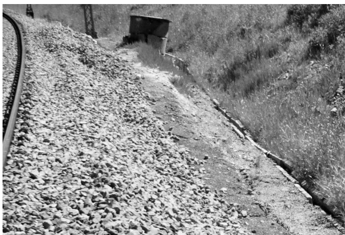
Rys. 3b. Czerwiec 2012 roku - widoczny całkowicie zgnieciony rów odwadniający (mat. arch. PLK)
