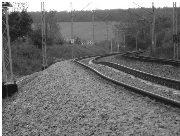
Rys. 2a. Maj 2010 roku – widoczna wyraźna deformacja toru spowodowana wypychaniem mas gruntu (mat. arch. PLK)
