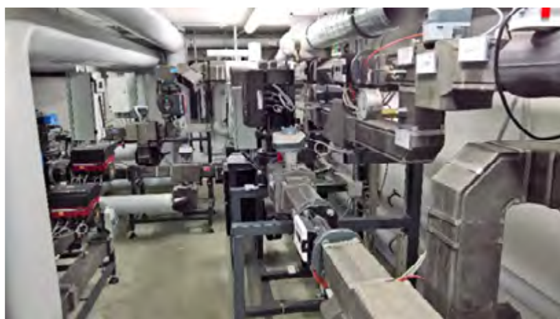
Rys. 2. Rozliczeniowy węzeł ciepłowny dla budynków plusenergetycznych Źródło: © Stefan Simonides, BTU Cottbus-Senftenberg, Niemcy
