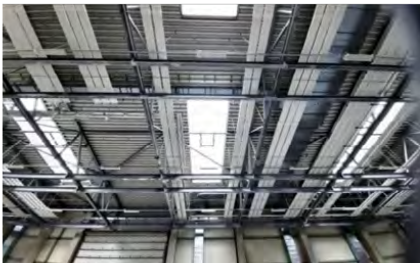
Rys. 9. Innowacyjny system radiacyjnego ogrzewania hal produkcyjnych
