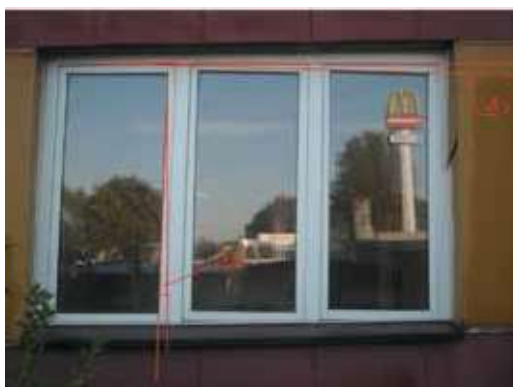
Rys. 2. Deformacja otworu okiennego w budynku przy ul. Pocztowej w Karbiu-Bytomiu, fot. L. Słowik, ITB, 2013 Fig. 2. Deformation of the window opening in the building at Poczta Street in Bytom-Karb, photo: L. Słowik, ITB, 2013
