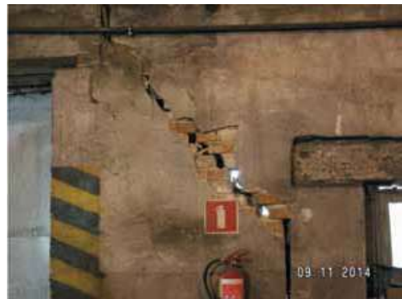
Rys. 7. Pęknięcie z rozsunięciem murowanej ściany między otworami, Mikołów, fot. własna
