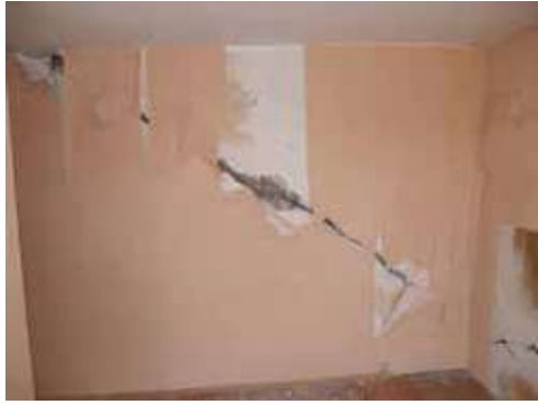
Rys. 4. Pęknięcie poprzecznej ściany nośnej w budynku przy ul. Pocztovej w Bytomiu-Karbiu, fot. L. Słowik, ITB, 2013
