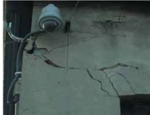
Rys. 5. Ukośne pęknięcie z rozsunięciem ściany zewnętrznej hali w Mikołowie – widok z zewnątrz, fot. własna
