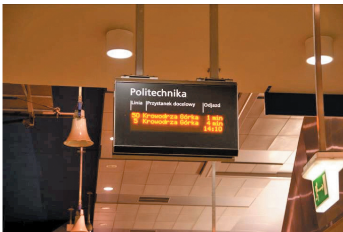
Fot. 6. Przykładowa tablica informacji pasażerskiej w tunelu tramwajowym
