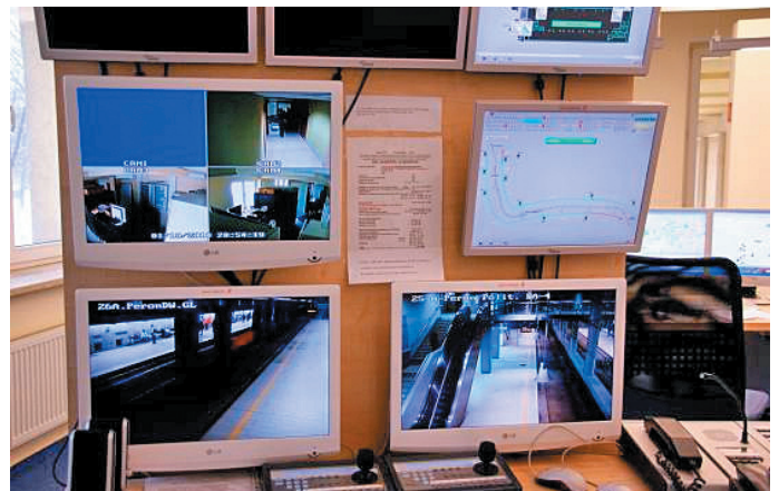
Fot. 3. Monitory systemu nadzoru tunelu krakowskiego Szybkiego Tramwaju
