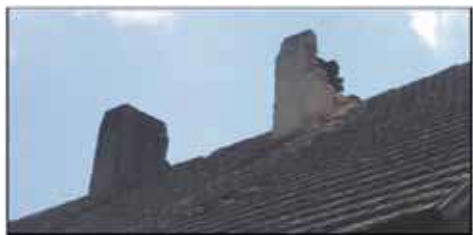
Rys. 6. Dokumentacja fotograficzna uszkodzonego komina ponad dachem budynku
