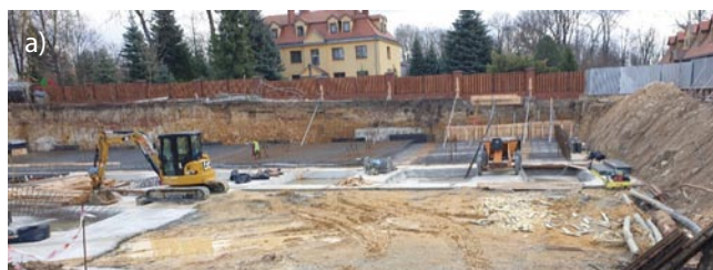
Rys. 1. Budynek mieszkalny wielorodzinny: a) widok braku zabezpieczenia wykopu, wobec strefy bezpośredniego oddziaływania wykopu realizowanej budowy na działkę sąsiednią
