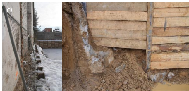
c) widok nieskutecznego zabezpieczenia wykopu; palisady nie wykonano na całej długości budynku, nastąpiło przemieszczanie się gruntu do wykopu pomiędzy palisadami oraz w obszarze przejścia z palisady na „ściankę berlińską”
