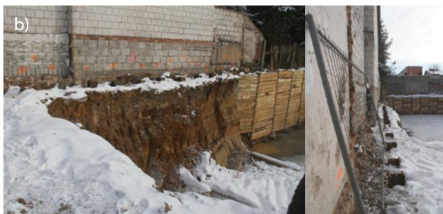
b) widok zabezpieczenia wykopu według rozwiązania projektowego ścianek „berlińskich”, a na „długości budynku” w postaci palisady z pali żelbetowych, których rozmieszczenie i dobór przerzucono na wykonawcę, zamiast wykonać stosowną dokumentację, na etapie opracowania projektu geotechnicznego
