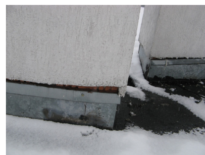
Fot. 4. Uszkodzenia listew startowych, degradacja systemu ETICS (fot. O. Kopyłow)
