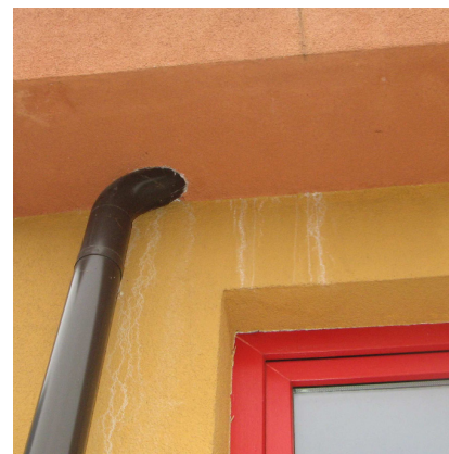
Fot. 13. Ślady zacieków na powierzchni ściany docieplonej w systemie ETICS na skutek nieszczelności przejścia rury spustowej przez płytę balkonu (fot. O. Kopyłow)
