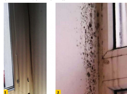
Fot. 12. Pleśń na styku okna ze ścianą spowodowana przemarzaniem (fot. O. Kopyłow [8])
