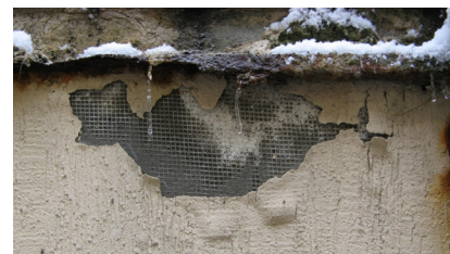
Fot. 2. Degradacja systemu ETICS na skutek uszkodzenia obróbek blacharskich na gzymsie (fot. O. Kopyłow)
