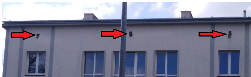
Fot. 1. Uszkodzenia systemu ETICS przez ptaki (fot. O. Kopyłow)
