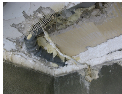
Fot. 8. Odspojenie systemu elewacyjnego w wyniku uszkodzenia instalacji kanalizacyjnej ścian.
