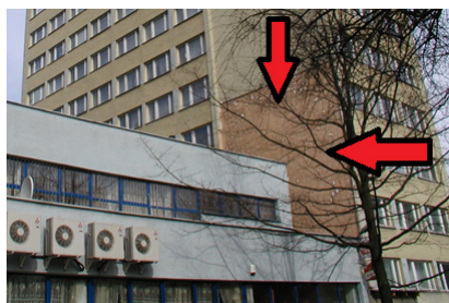
Fot. 7. Obszar elewacji z oderwanym fragmentem ETICS na skutek oddziaływania wiatru oraz pomyłek wykonawczych. Strzałki wskazują miejsca zerwanych wiatrem fragmentów systemu elewacyjnego [6] (fot. O. Kopytów)
