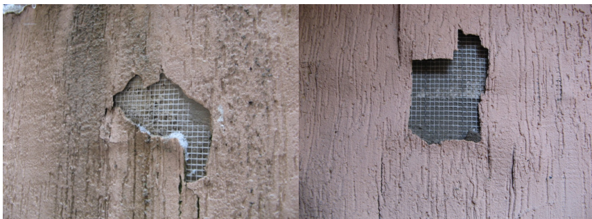
Fot. 5. Degradacja systemu elewacyjnego ETICS w miejscach uszkodzeń mechanicznych (fot. O. Kopytów)
