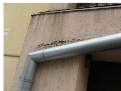
Fot. 3. Degradacja systemu ETICS wskutek uszkodzenia rury spustowej (fot. O. Kopyłow)
