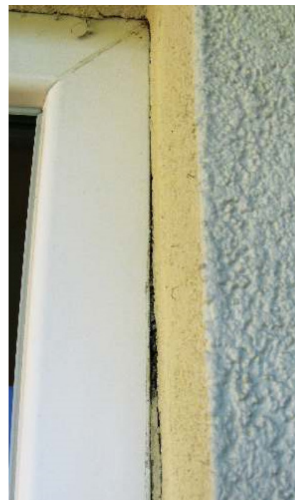
Fot. 11. Brak zewnętrznej warstwy termoizolacyjnej ramy okiennej oraz warstw uszczelniających połączenie rama okienna-mur (występuje jedynie pianka montażowa) (fot. O. Kopyłow [7, 8])
