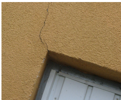
Fot. 10. Spękanie w narożu otworu drzwiowego powstałe w wyniku pomyłek montażowych (fot. O. Kopyłow)
