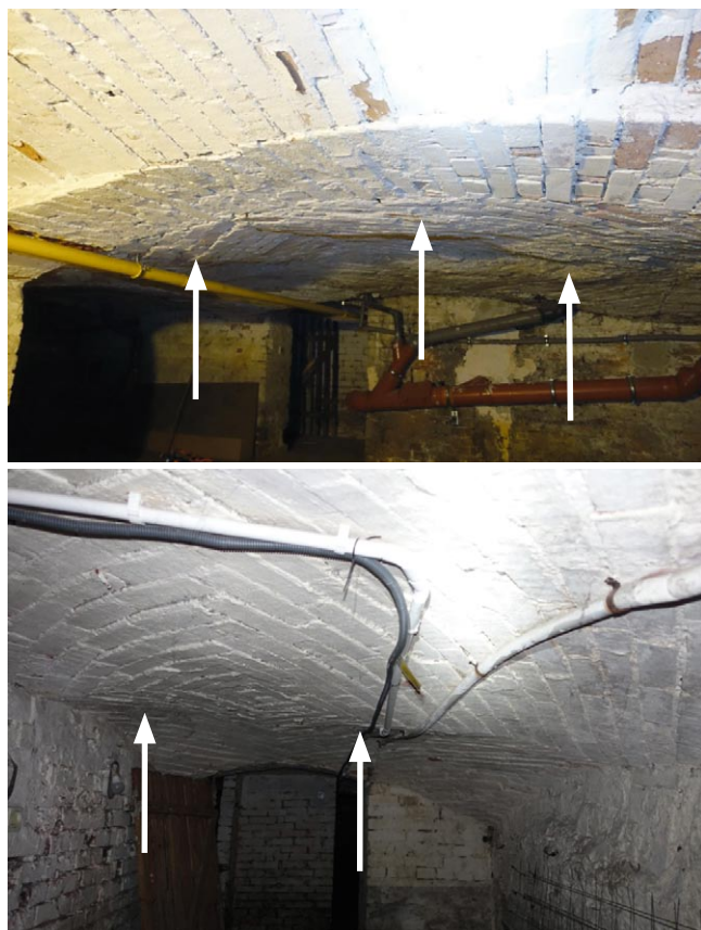
Rys. 2. Nierówno odkształcone sklepienia beczułkowe (miejsca zapadnięte oznaczono strzałkami)
