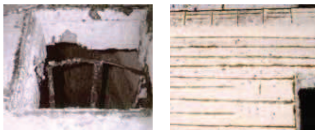
Rys. 3. Właz do przepompowni ścieków i korozja betonu stropu i zbrojenia od spodu
