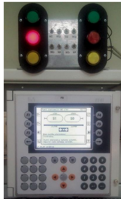
Rys. 5. Widok panelu diagnostycznego typu EZG-21 oraz symulatorów semaforów odstępowych w Laboratorium Systemów Sterowania Ruchem Kolejowym [opracowanie własne]
