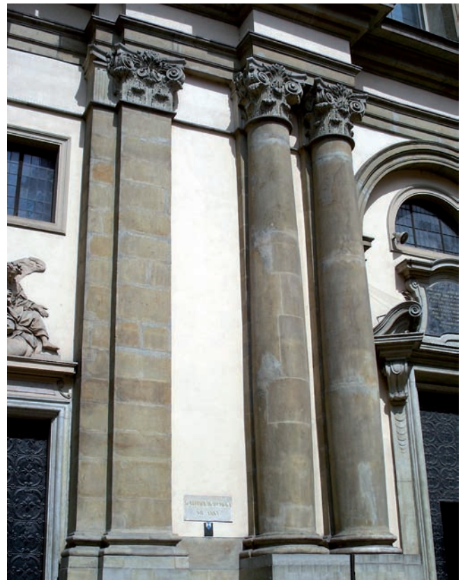
Fig. 3. The SE façade of the church – the plinth made of the Istebna Sandstone ashlars, the stars cut of the Cretaceous Quader Sandstone, phot. M. Florczyk • Elewacja SE kościoła – cokół z ciosów piaskowca istebniańskiego, schody z kredowego piaskowca ciosowego, fot. M. Florczyk
