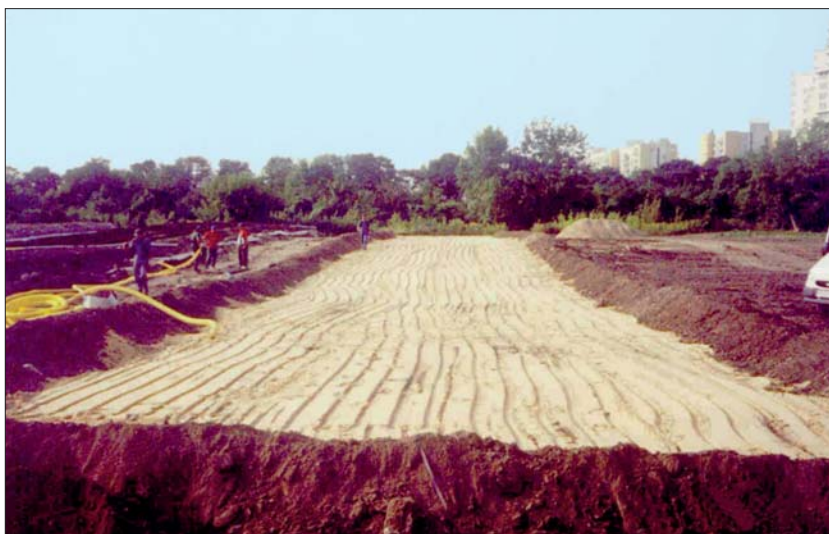
Ryc. 2. Pryzmy biorekultywacyjne wykonane w celu oczyszczenia gruntów przeznaczonych pod budowę centrum handlowego Arcadia w Warszawie. Fot. S. Wołkowicz Fig. 2. Biopiles made in order to cleanse lands allocated for the construction of the shopping centre Arcadia in Warsaw. Photo by S. Wołkowicz
