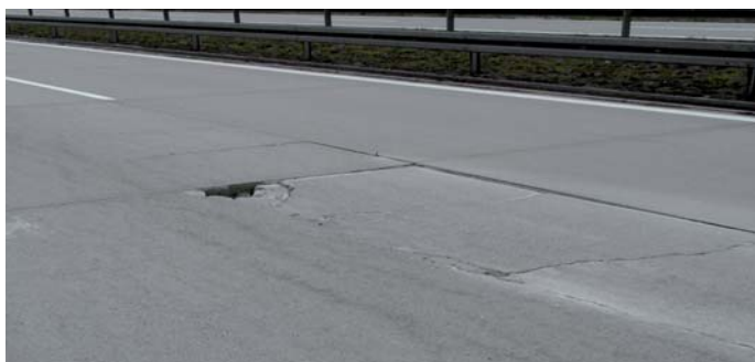
Fot. 1. Uszkodzenie strukturalne – spękanie oraz zapadnięcie płyt nawierzchni wraz z wykruszeniem naroży – autostrada A4 [4]
