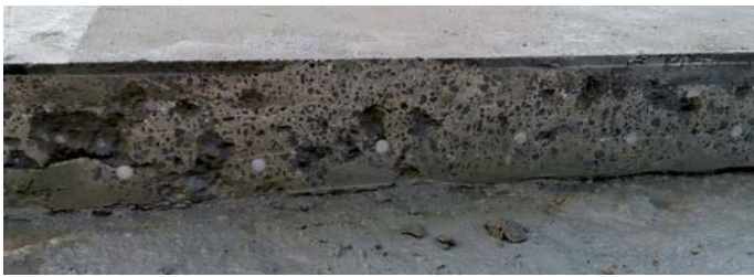
Fot. 13. Układ istniejących dybli w sąsiedniej płycie; widoczne pofalowanie i brak osiowości całego zestawu prętów [7]
