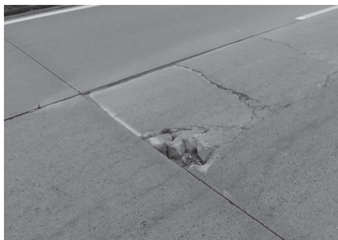
Fot. 2. Spękania i zapadnięcie się nawierzchni, autostrada A4, odcinek pierwszy, km 53+550, stan luty 2019 r. [7]
