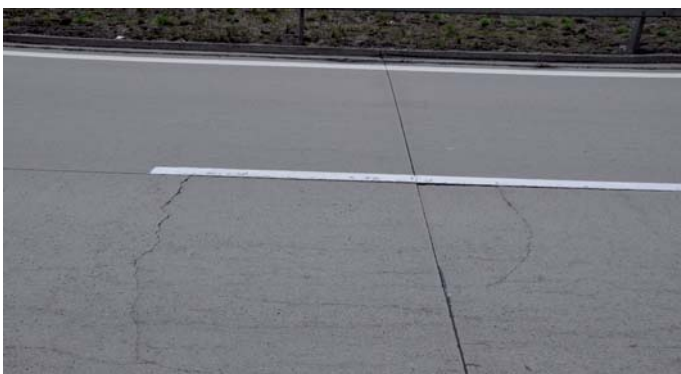
Fot. 3. Spękania i zapadnięcie się płyt nawierzchni, autostrada A4, odcinek drugi, km 53+525, stan marzec 2019 r. [7]
