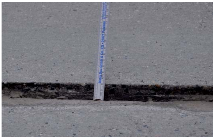
Fot. 4. Różnica poziomów pomiędzy sąsiednimi płytami nawierzchni, autostrada A4 km 53+550 [7]
