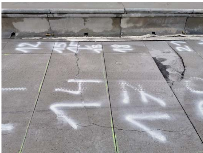
Fot. 9. Obrysowane fragmenty płyty oraz wykonane nacięcia uszkodzonej nawierzchni [7]
