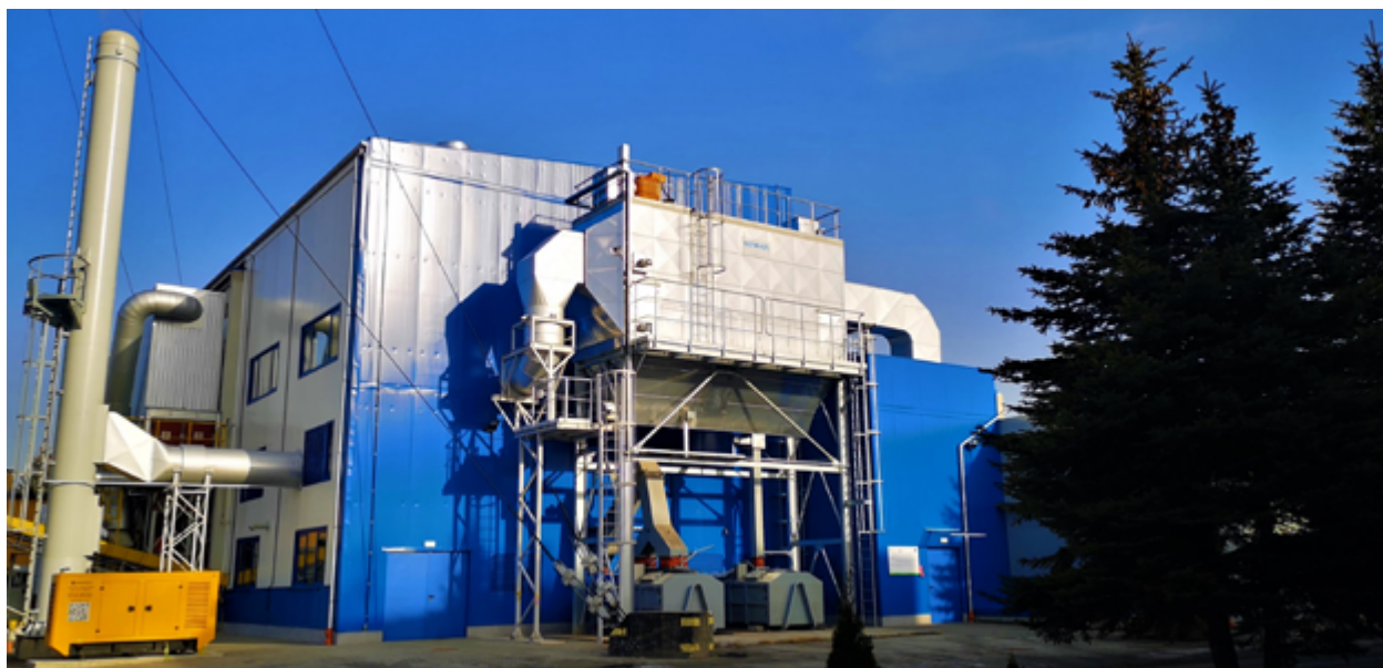
Fot. 1. Kocioł na biomasę o mocy 7 MW
