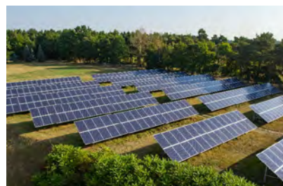
Fot. 3. Instalacja fotowoltaiczna
