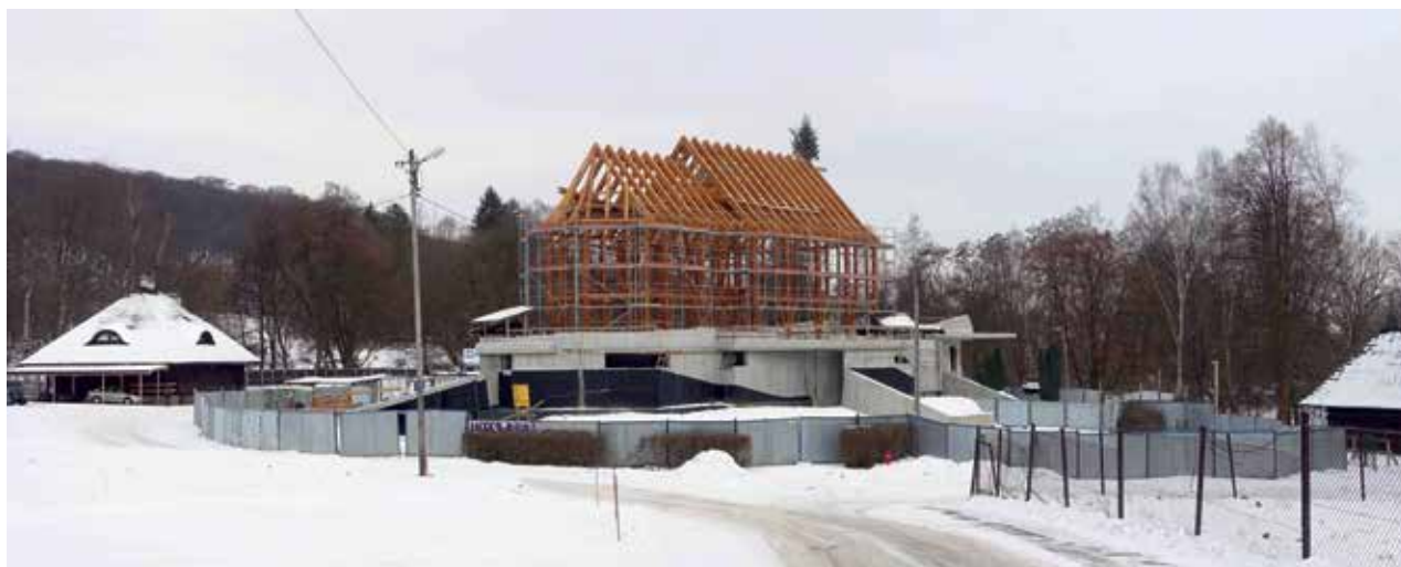
Il. 21. Konstrukcja drewniana w budowie, widok ogólny, stan w styczniu 2017. Fot. aut.
