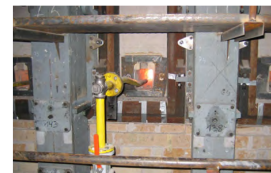
Rys. 1 Widok tymczasowego palnika rozpalowego instalowanego w czasie rozgrzewania baterii koksowniczej na wlocie do komory
