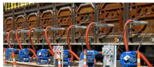
Rys. 3. Rozgrzewanie baterii koksowniczej dwuproduktowej za pomocą automatycznie sterowanych palników gazowych [5].
