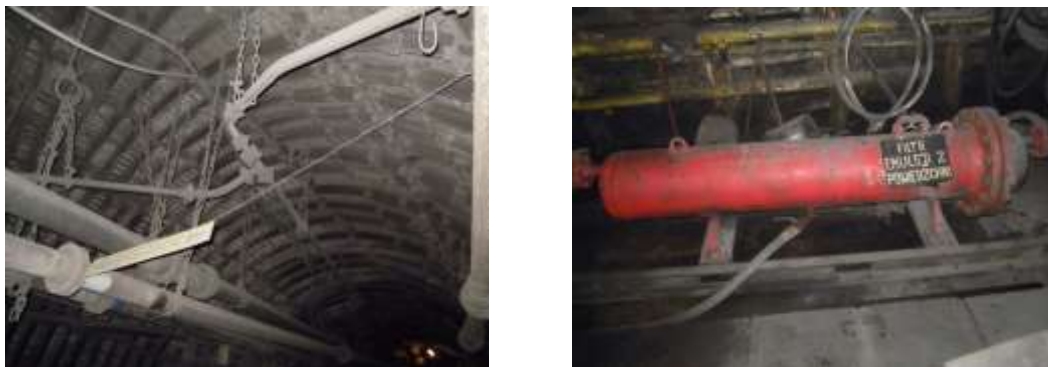
Rys. 12.5 Rurociągi doprowadzające emulsję na poziomie wydobywczym do dwóch centralnych stacji pomp wysokociśnieniowych oraz filtry
