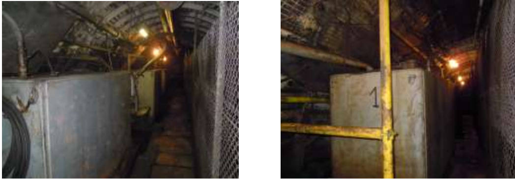
Rys. 12.4 Zbiorniki z emulsją na stacjach pomp wysokociśnieniowych
