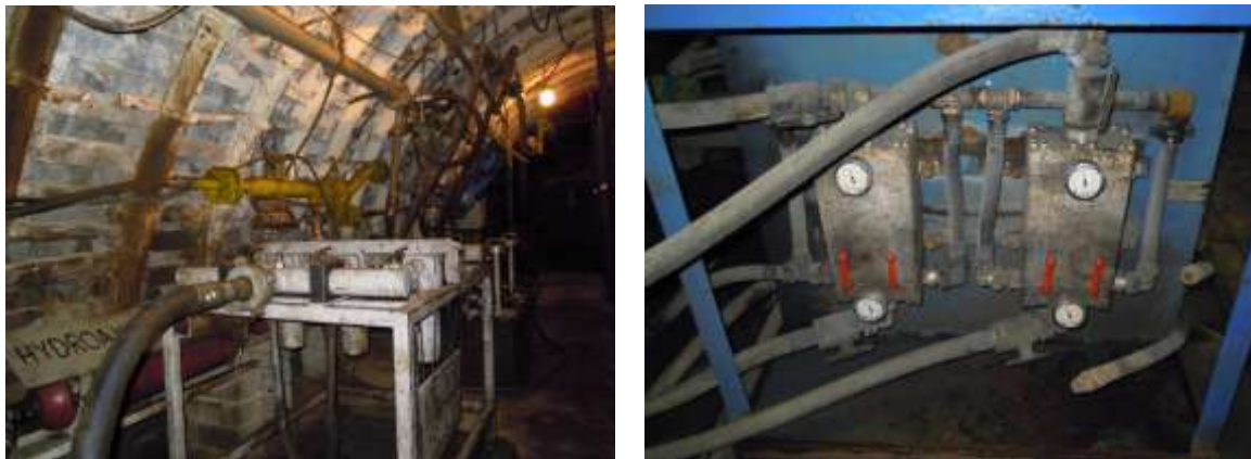
Rys. 12.15 Akumulator hydrauliczny oraz filtry tłoczne wysokociśnieniowe samoczyszczące Źródło: [2]
