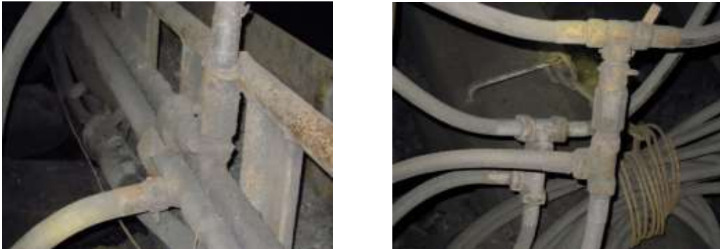
Rys. 12.11 Zasilanie sekcji obudowy zmechanizowanej w ścianie
