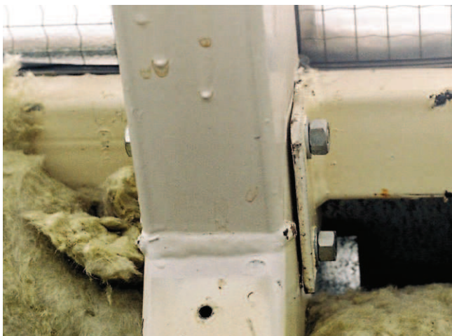
Rys. 5. Stan połączenia rygla okapowego z ramą
