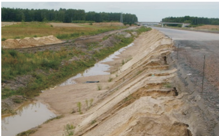
Rys. 4.3. Uszkodzenia poboczy oraz skarp
