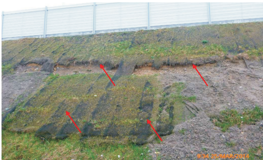
Rys. 4.4. Widoczne fałdy geosyntetyku świadczące o spłynięciu tego materiału (czerwone strzałki) wraz z humusem pod geosyntetykiem, widoczne są miejsca przytwierdzenia kotwami materiału wzmocniającego do skarpy, materiał wzmocniający (czarny) jest odkryty przez wypłukanie z jego struktury humusu
