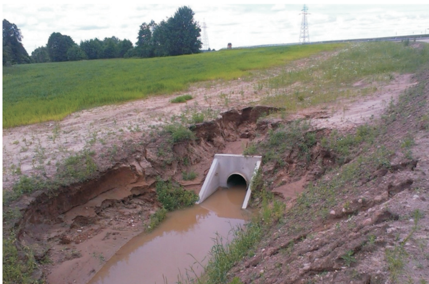
Rys. 4.1. Zniszczenie wlotu kanalizacyjnego oraz osunięcie i rozmycie skarpy rowu
