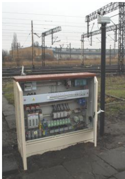
Rys. 5. System elektrycznego ogrzewania rozjazdów. Źródło: Archiwum AREX Sp. z o.o.
