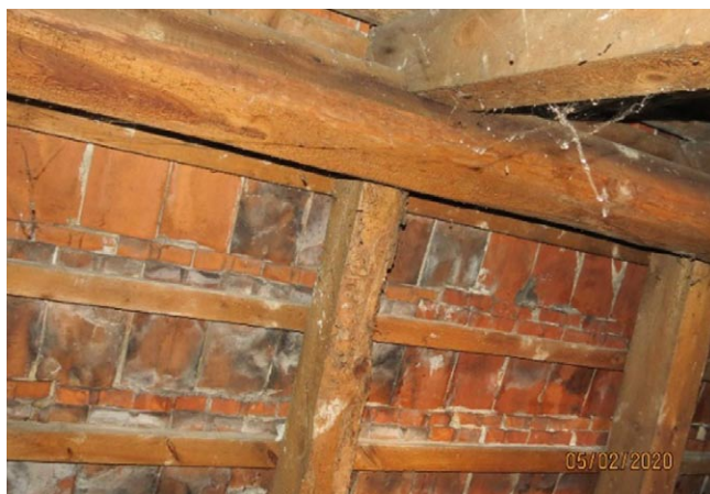
Rys. 16. Korozja biologiczna więźby dachowej
