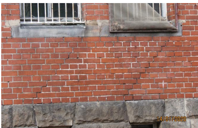
Rys. 8. Typowe ukośne zarysowania ścian
