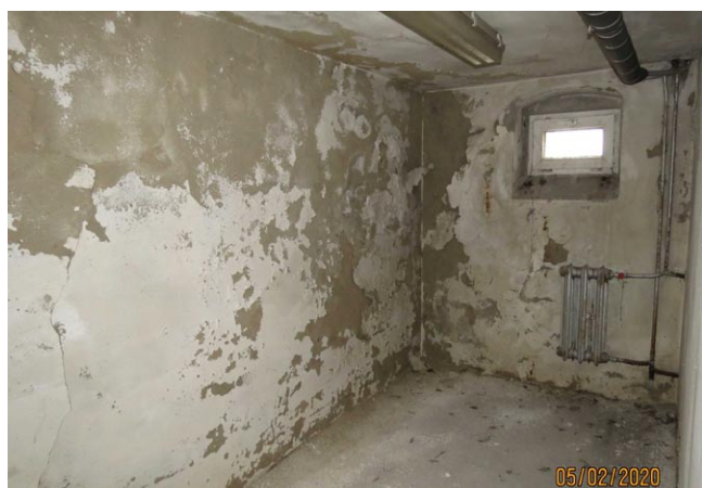
Rys. 15. Zawilgocenie ścian w piwnicy
