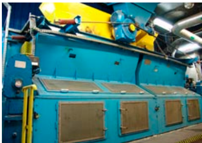
Kocioł OR-32/50-N K4 w elektrociepłowni w Polkowicach
