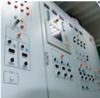
Szafa AKPIA kotła OR-50
