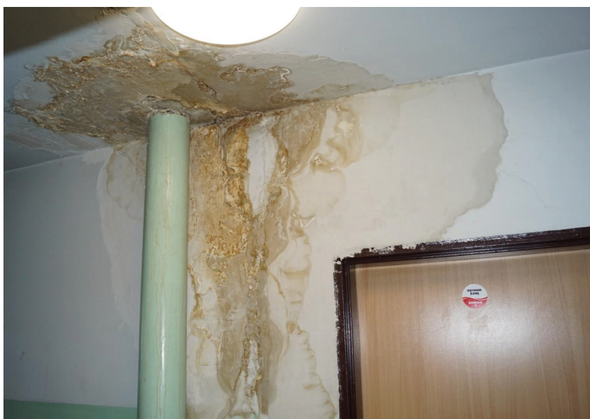
Rys. 10. Widok skutków przecieku wód opadowych wokół rury spustowej na ostatniej kondygnacji budynku (Poznań 2021)
