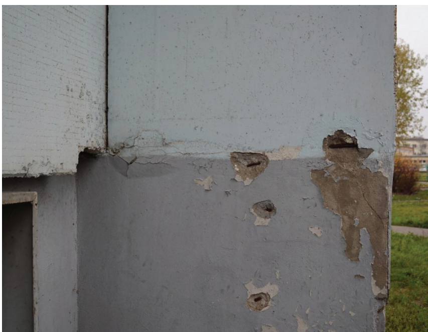
Rys. 7. Zniszczenia korozyjne w następstwie karbonatyzacji betonu w ścianie loggii (Poznań 2019)
