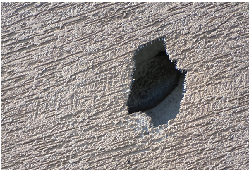
Rys. 4. Uszkodzenie elewacji przez ptaki (Warszawa 2017)
