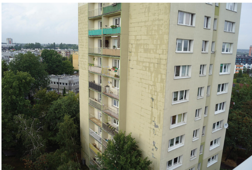
Rys. 3. Odpadające fragmenty tynku zewnętrznego cienkowarstwowego (Poznań 2021)
