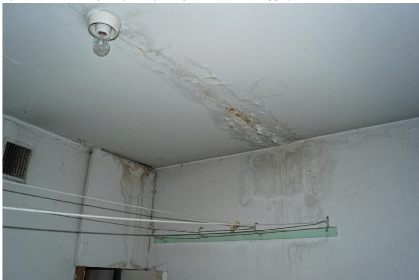
Rys. 9. Widok skutków przecieku wód opadowych w miejscu styku płyt stropowych nad ostatnią kondygnacją budynku (Poznań 2021)
