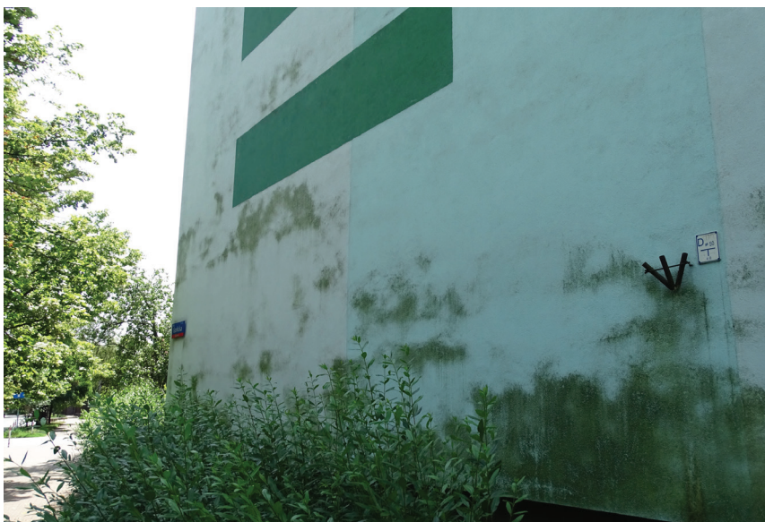
Rys. 5. Agresja biologiczna na elewacji (Warszawa 2016)
