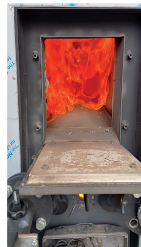
Rys. 8. Spalanie syngazu w komorze spalania
