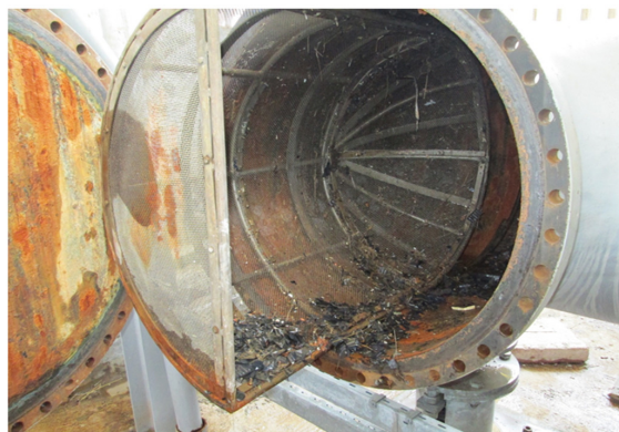
Rys. 8. Zanieczyszczenia w filtrze na ssaniu pompy
